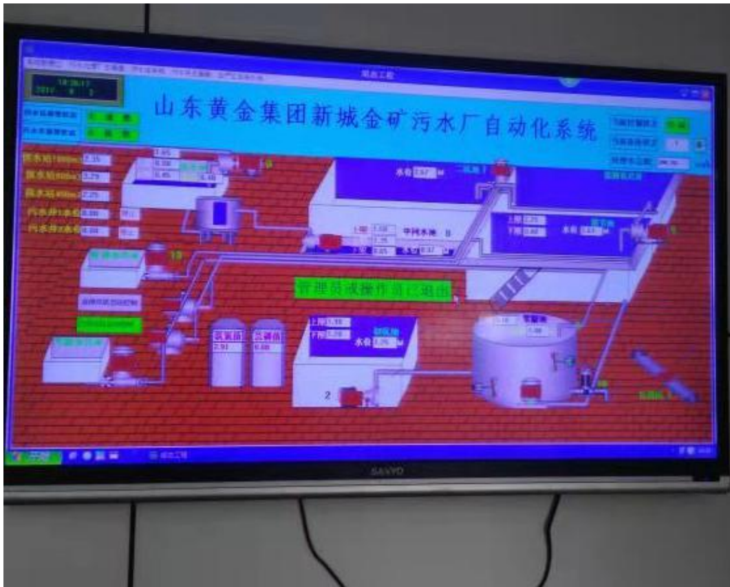
污水处理站控制系统
