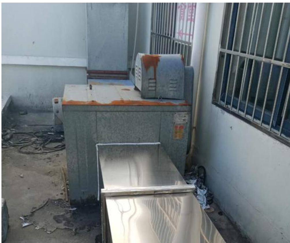
油烟净化设施及排气筒
