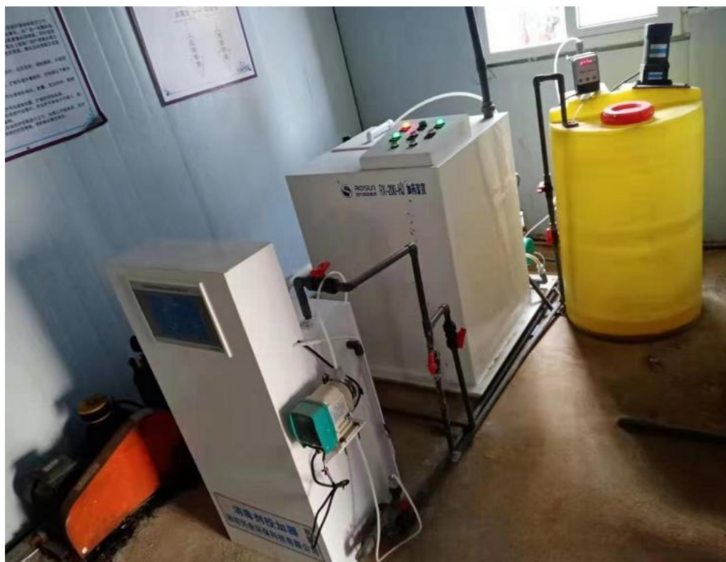
污水处理设施
