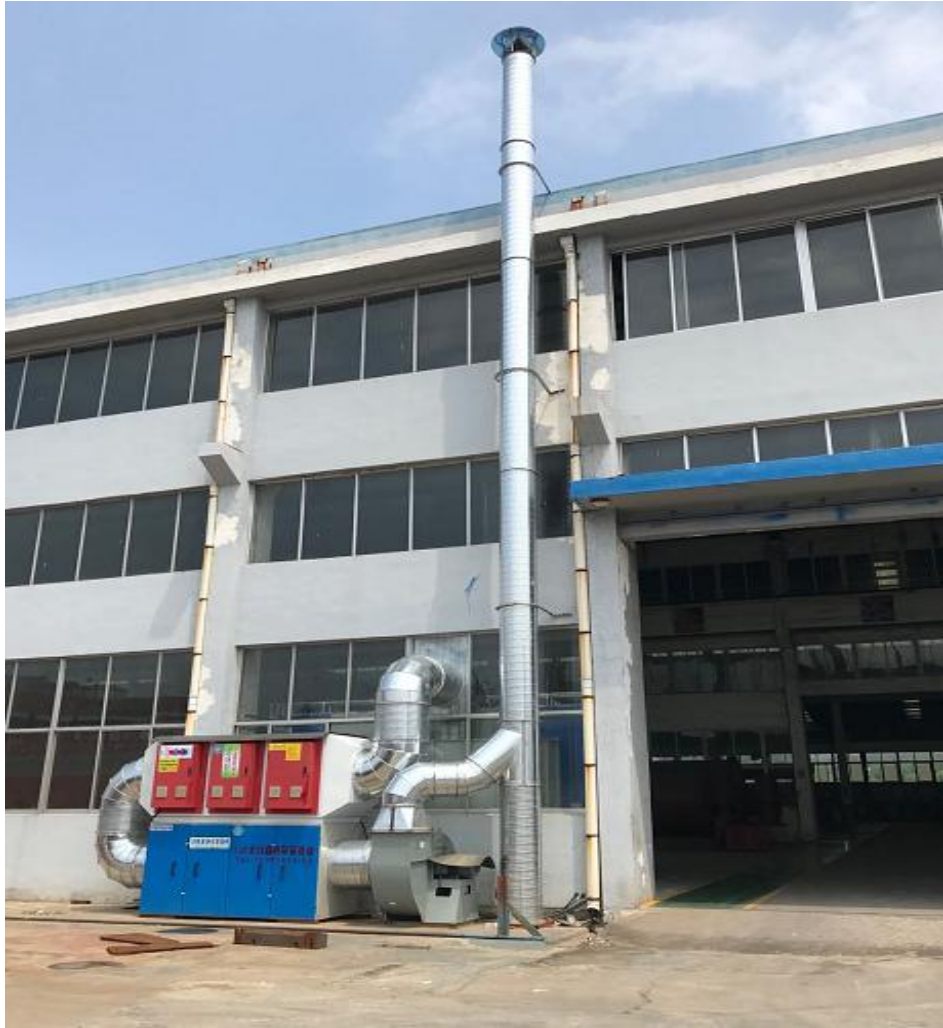
废气处理设施及排气筒
