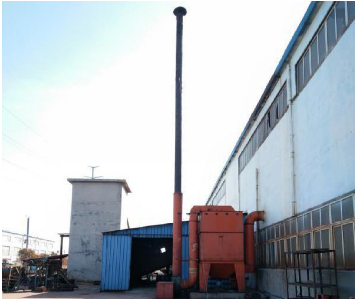
图3-2 抛丸布袋除尘器及排气筒
