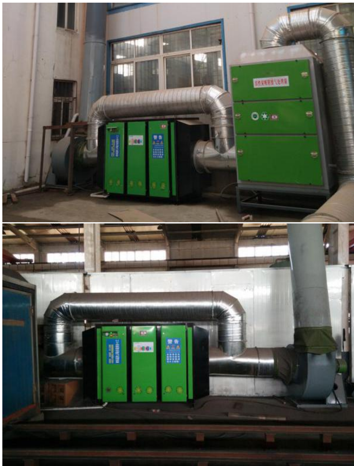
图3-1 喷漆废气处理设施
