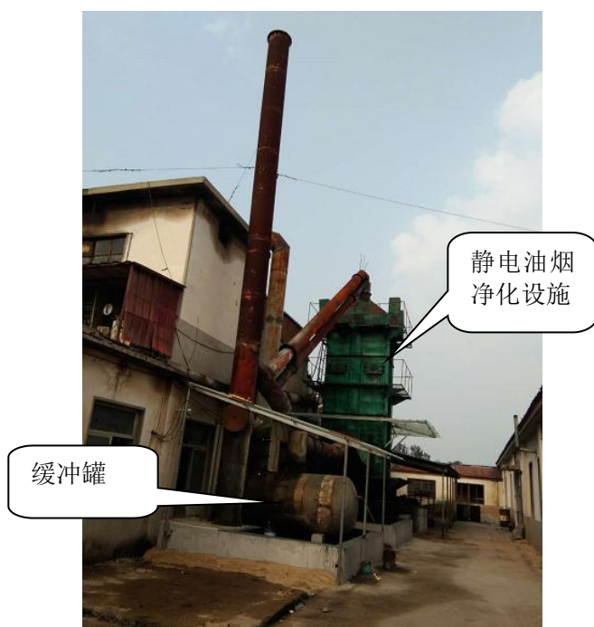
废气处理装置
