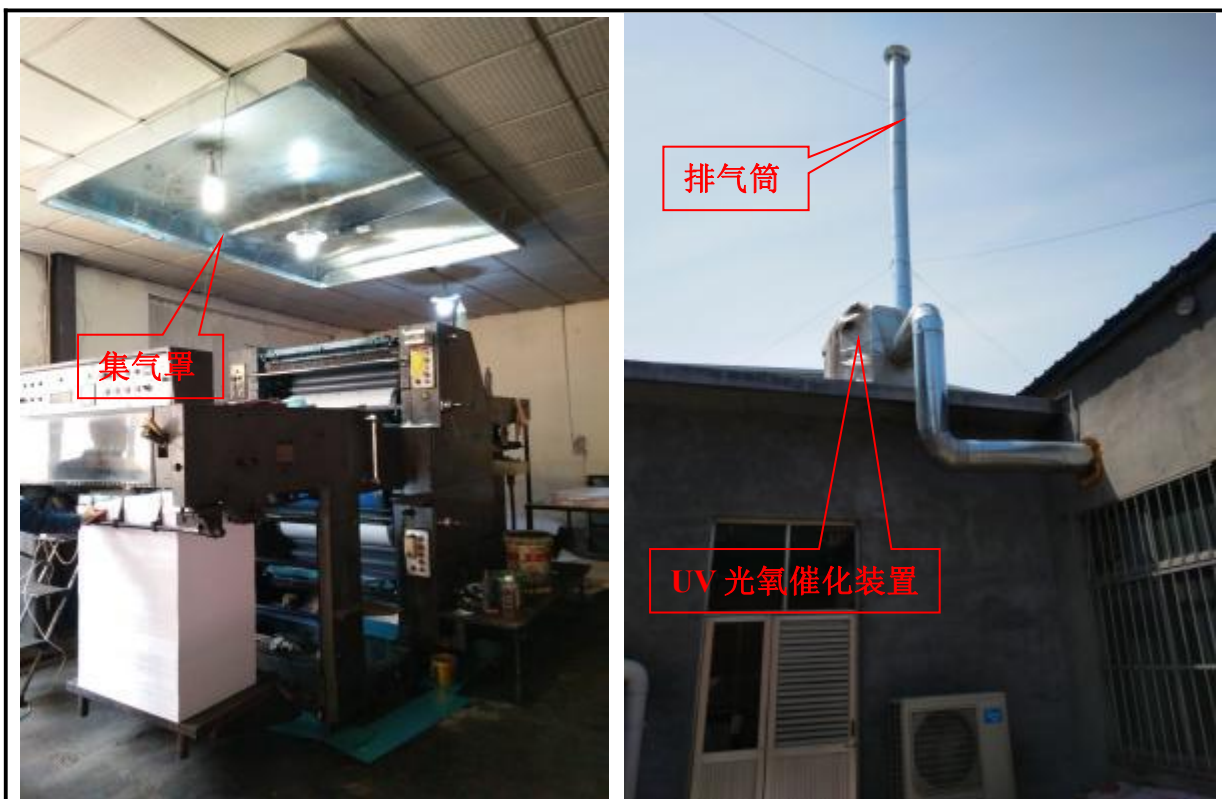
图 3-1 废气处理设施及排气筒
