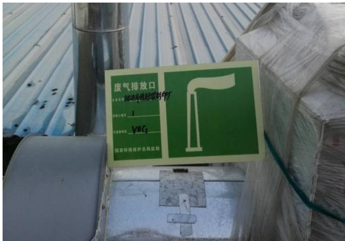
图 3-2 排气筒标识牌
